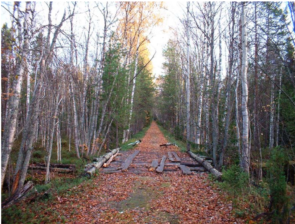
Фото № 4. Линия Филимоновской ветки на 7-м км. у оз. Иосифово. Фото 2004 г.
